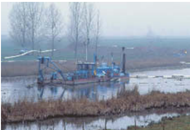
Abb. 5: Ein stark verschlammter Abschnitt des Bienener Altrheins wurde 1982 mit Hilfe eines Saugspülbaggers entschlammt.
